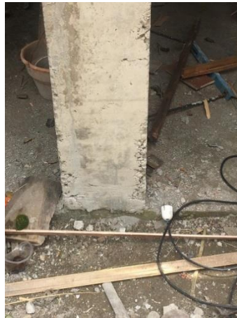
Gambar 4.18 Kolom Keropos dan Retak (Sumber: Dokumentasi Pribadi)
