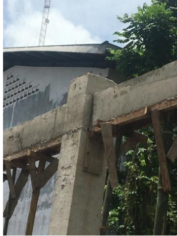
Gambar 4.17 Kolom Keropos (Sumber: Dokumentasi Pribadi)
