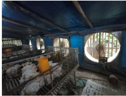
Gambar 4. 10 Ventilasi di Peternakan Kandang Rahayu
