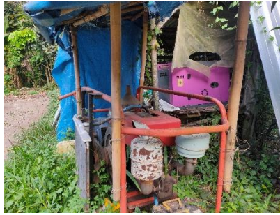
Gambar 4. 13 Generator Listrik di Peternakan Kandang Rahayu
