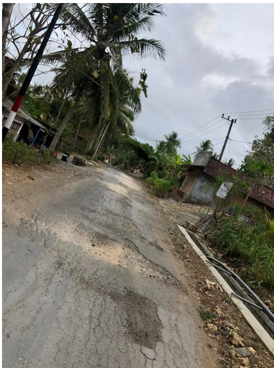
Gambar 6. Kondisi Jalan Ruas Sidomulyo – Bakung (Sumber: Observasi Lapangan , 2025)
