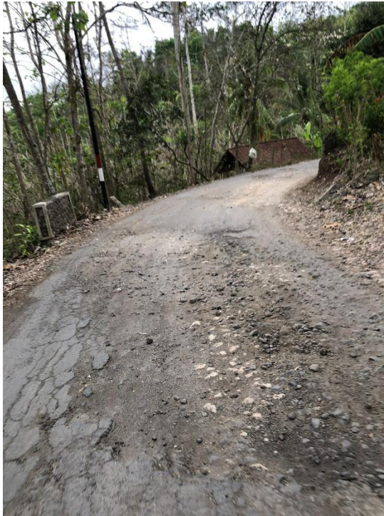
Gambar 5. Kondisi Jalan Ruas Sidomulyo – Bakung (Sumber: Observasi Lapangan , 2025)
