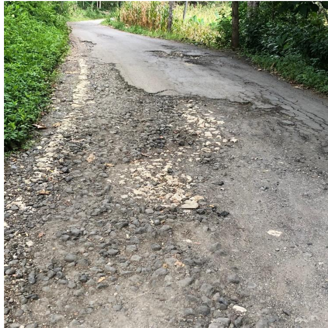
Gambar 3. Kondisi Jalan Ruas Sidomulyo – Bakung (Sumber: Observasi Lapangan, 2025 )
