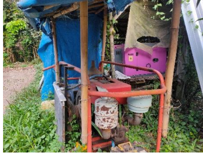
Gambar 4. 13 Generator Listrik di Peternakan Kandang Rahayu
