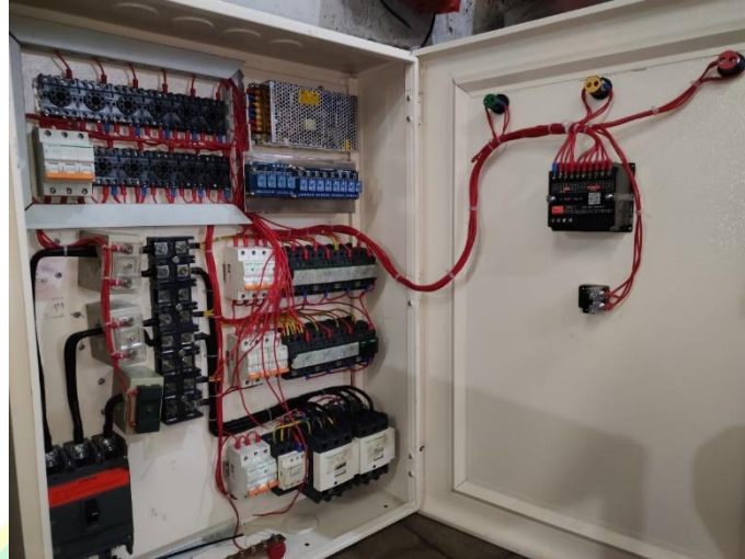
Gambar 13 Rangkaian Kontrol Panel Induk
