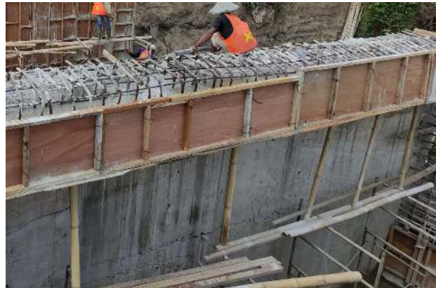
Gambar 4.28 Salah satu kecacatan pada abutment
