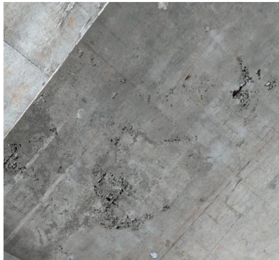
Gambar 2. 15 Segregasi pada plat lantai
